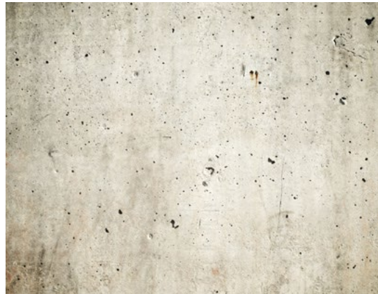
Beton o strukturze plastra miodu
